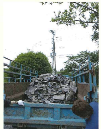
ガレキを積んだタンク
